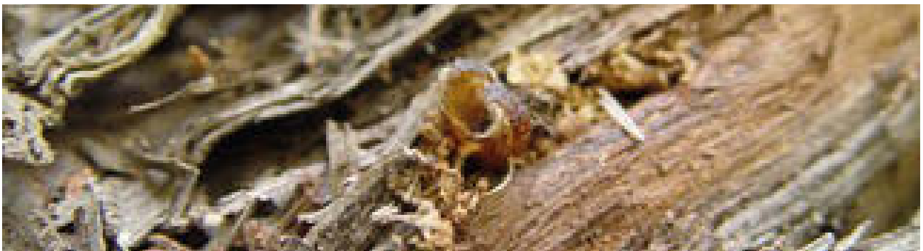
FIGUUR 3 Tunnel opening waar mot uit papie verpop het.
